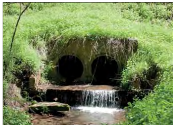
Abbildung 152: Beeinträchtigende Bachverrohrungen wie hier im Helingsbach werden sukzessive z. B. im Rahmen von LIFE-Projekten zurückgebaut (Foto: Andreas Pardey)
